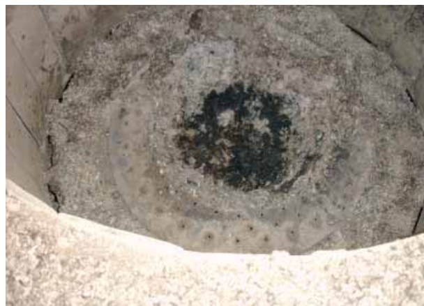
Hackschnitzelheizung (300 – 500 kW), Detail: Brennraum mit Unterschubfeuerung/Glutbett, Primärluftdüsen im Brennteller, Ascheabreinigung durch Rüttelvorrichtung
