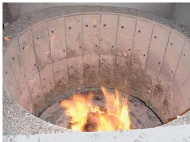
Hackschnitzelheizung (300 – 500 kW), Detail: Brennraum, Brennstoffzufuhr im Unterschub, Sekundärluftdüsen in der Seitenwand
